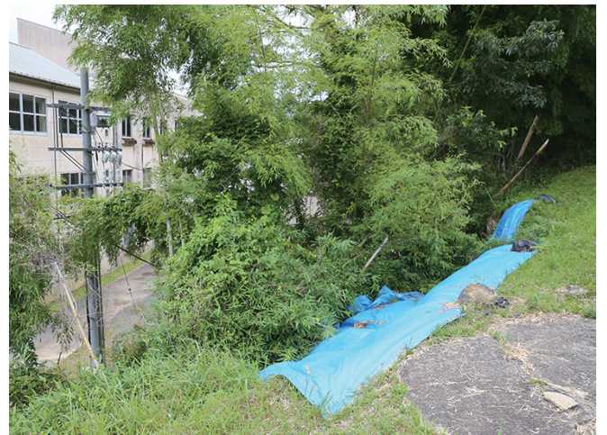
旧西中学校校舎裏擁壁崩落現場
