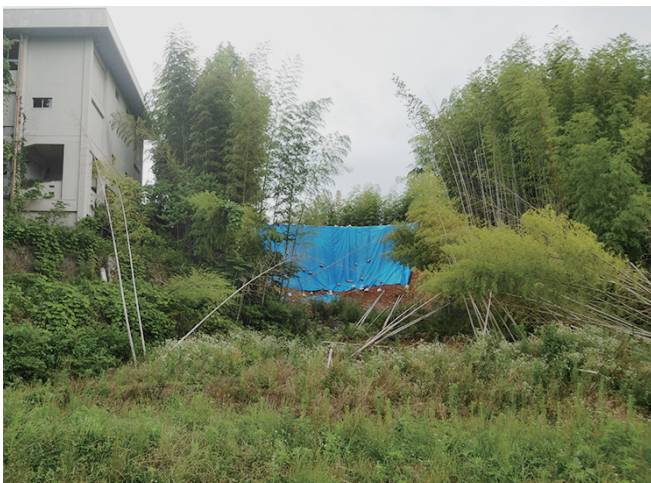
旧東郷小学校運動場法面崩落現場
