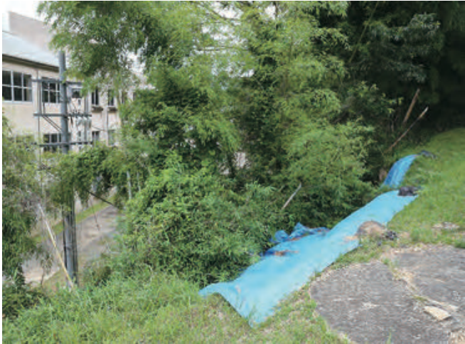
旧西中学校校舎裏擁壁崩落現場
