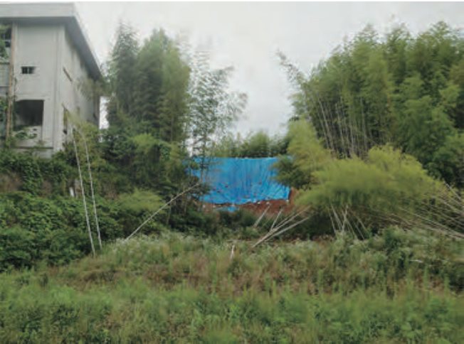
旧東郷小学校運動場法面崩落現場
