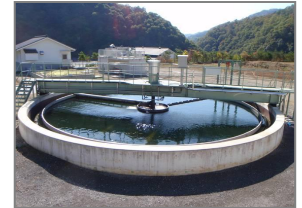
④最終沈殿池
