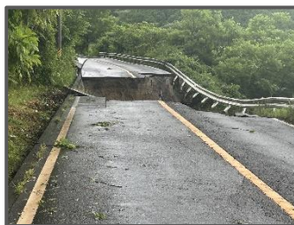
【崩落箇所の様子】
