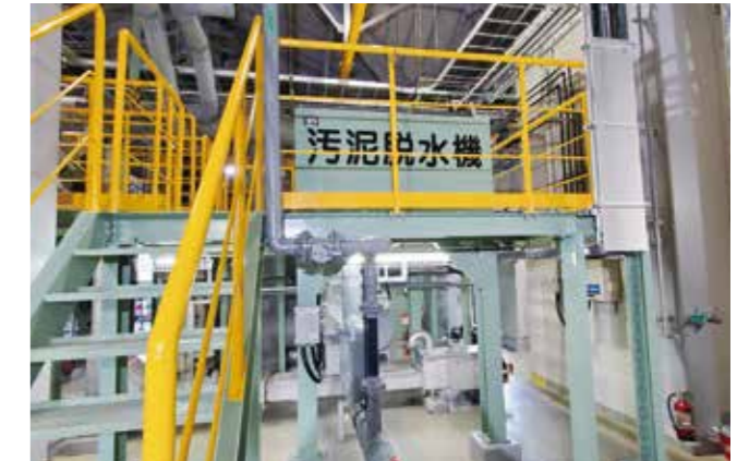
汚泥脱水機(防音ボックス)
